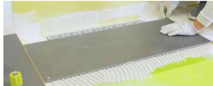
Incollare le piastrelle in prossimità dello scarico. Esse vanno posizionate in battuta al tappo da costruzione.
